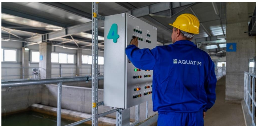
Stația de tratare a apei Bega, Aquatim SA
